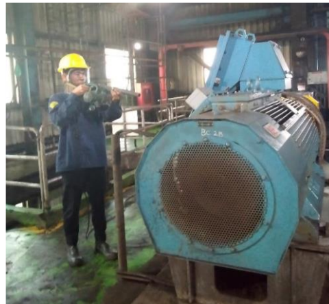
Gambar 5. Melakukan cleaning pada motor belt conveyor (BC)
