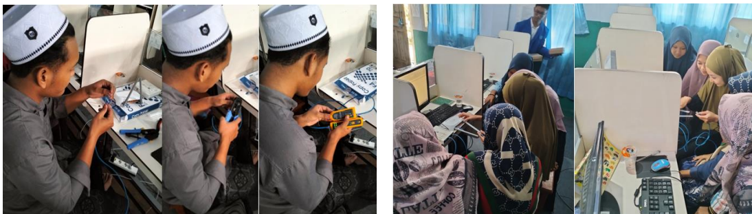
Gambar 6. Perkabelan dan Instalasi perangkat jaringan
