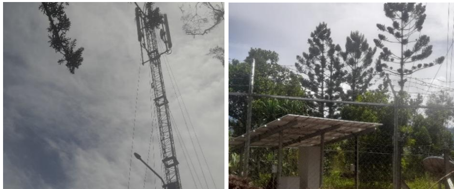
Gambar 5.6. Jaringan Telekomunikasi di Kampung Perabaga Distrik Piramid
