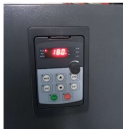
Gambar 12. VFD Pada Inverter (Sumber : Dokumentasi Pribadi)
