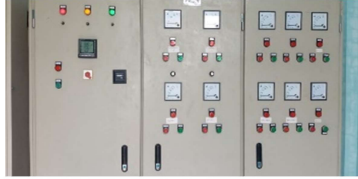
Gambar 7. Panel MCC-300 (Sumber : Dokumentasi Pribadi)
